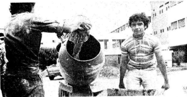
Los muchachos de JP de Lanús trabajan fuerte en la reconstrucción del Hospital Vecinal.
