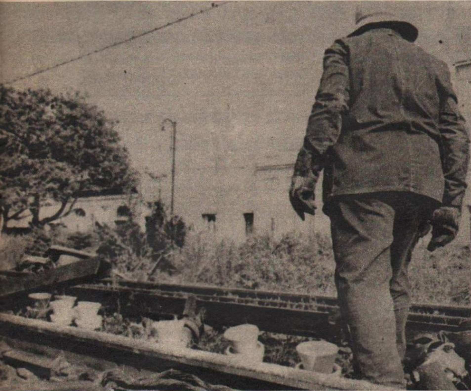
Reparando tramos de vías en la zona del Gran Buenos Aires, la Reconstrucción Nacional también se hace en el ferrocarril.
