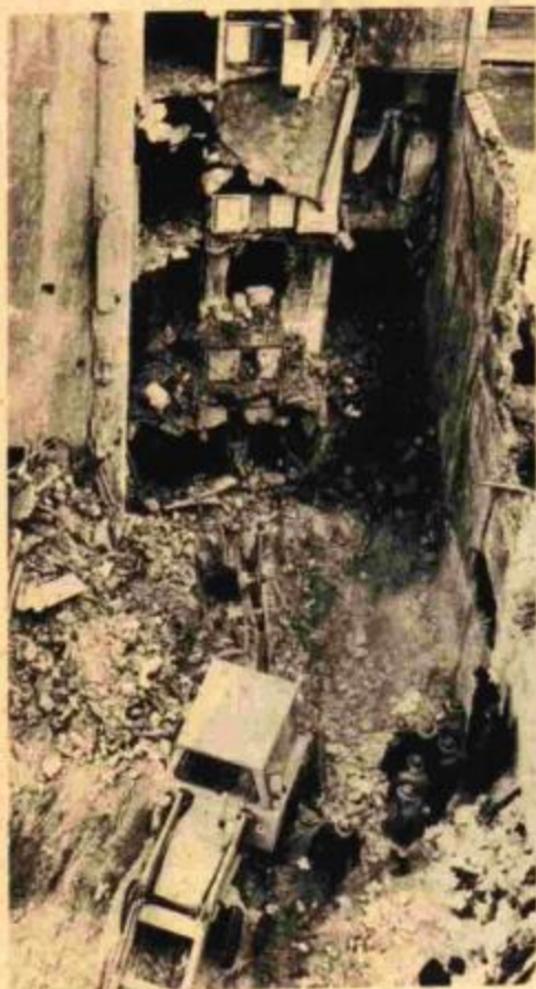
Un error de cuatro inconscientes y siete pisos derrumbados como arena seca.
