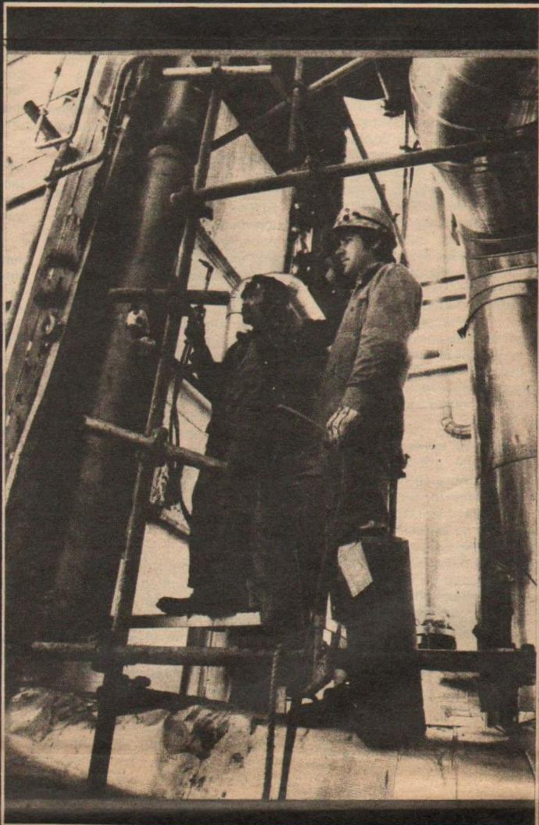
Los trabajadores reparan el horno de etileno que no funcionaba al iniciarse el conflicto para garantizar la continuidad de la producción.
